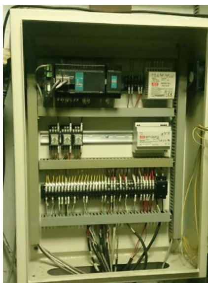
圖 5-8 機箱內增修前
