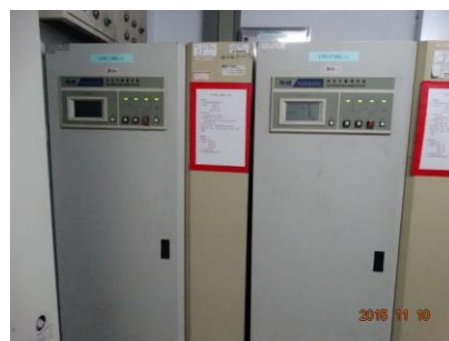
圖 3 機房 UPS 不斷電系統
