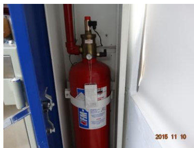
圖 5 機房消防系統
