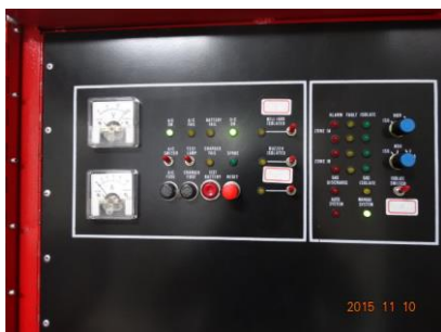
圖 4 機房消防控制面板
