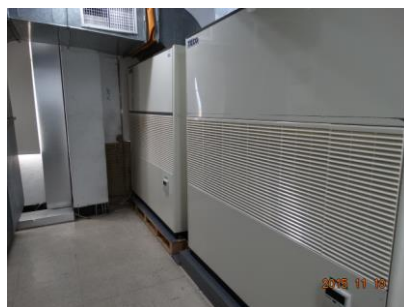
圖 6 機房空調主機
