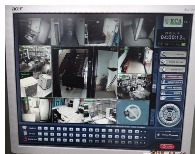
圖 2 機房錄影監視系統
