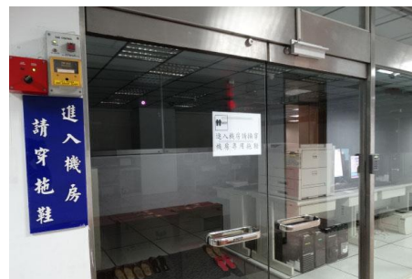
圖 1 機房入口門禁系統
